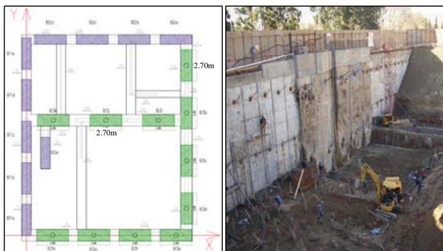
Figura 4. Planta de la fundación de los núcleos con barretas y foto de la construcción terminada.
