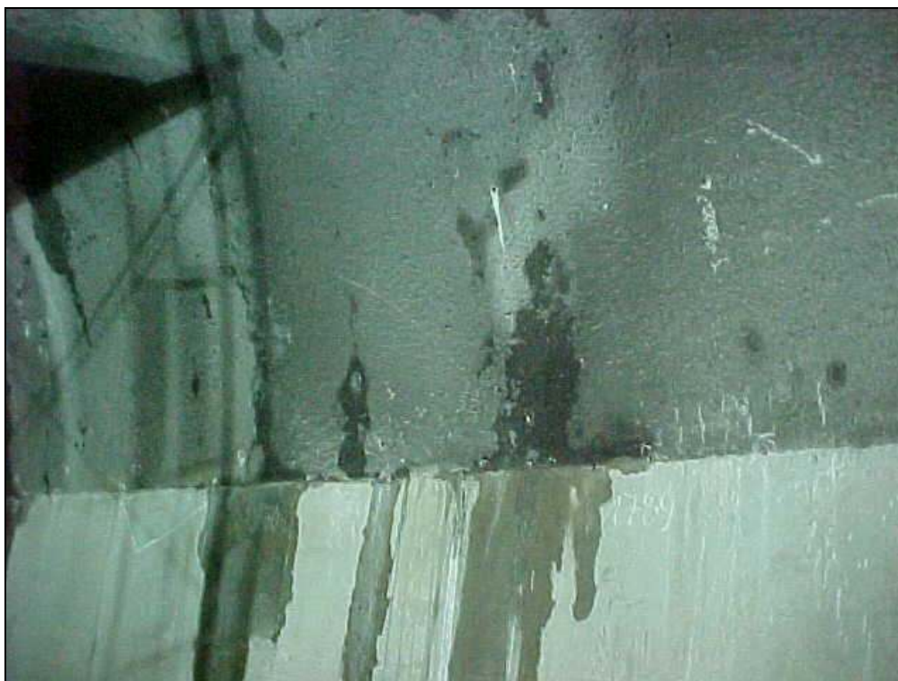
Fig. 7. Contacto entre hormigón proyectado (superior) y moldeado (inferior). Línea B, 1999.
